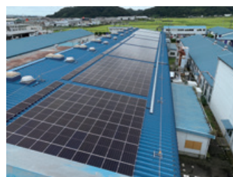
湯本工場の太陽光発電
