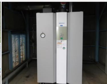
蒸気ボイラー（湯本工場）
