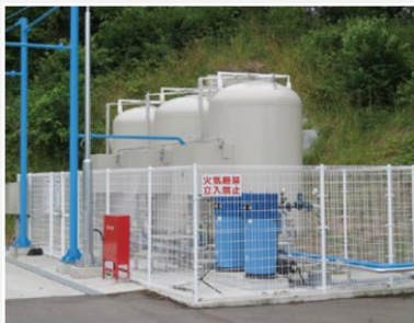
LPGガスタンク（湯本工場）
