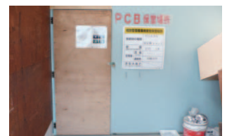
PCB廃棄物の保管庫
