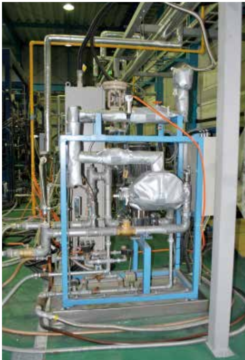
銀色のシートが断熱ジャケット
