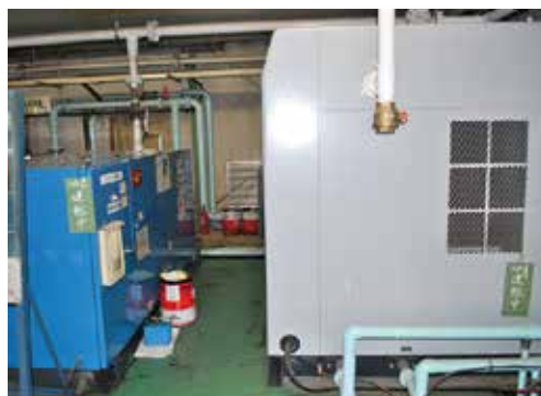
コンプレッサー室
