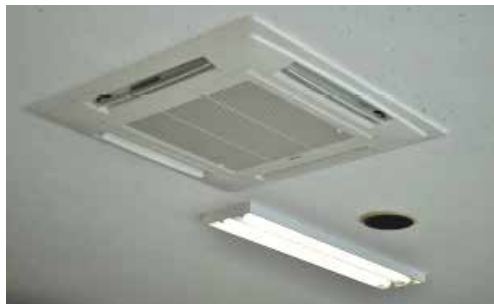
研修センターに設置された省エネ型エアコン
