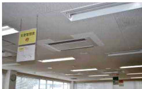
事務所棟に導入されたLED照明
