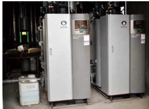
2015年に省エネ診断を受けたボイラー施設
