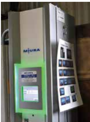
ボイラー台数制御装置
