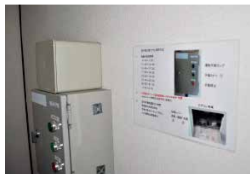
厚生棟更衣室に設置されエアコン操作盤
