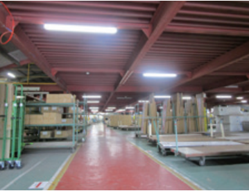
鹿島工場のLED照明
