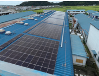
湯本工場の太陽光発電
