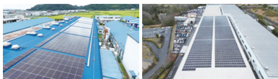
工場に設置した太陽光発電設備 (左: 湯本工場、右: 岡山工場)
