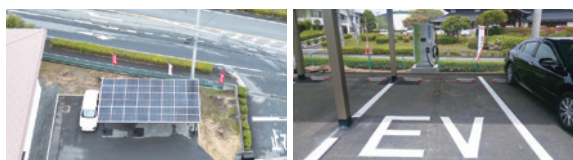
駐車場に設置したソーラーカーポート
