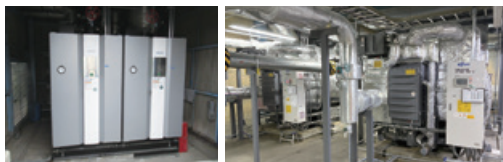
LNG用ボイラー （クレート工場）
