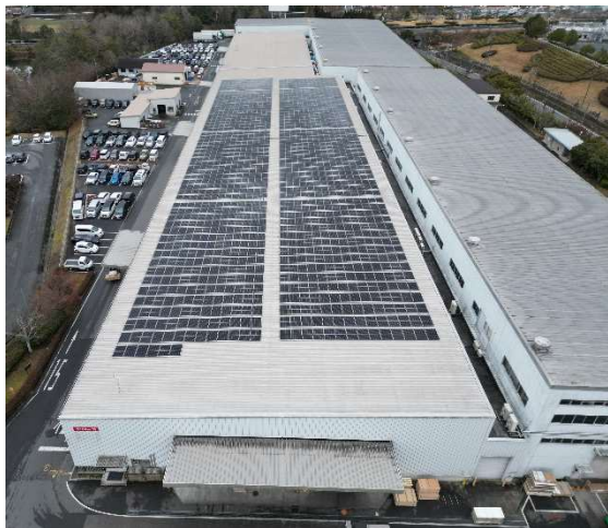
岡山工場屋上に設置した太陽光発電パネル
