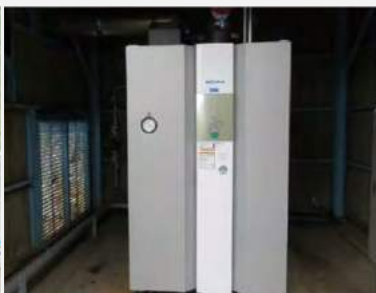
蒸気ボイラー（湯本工場）
