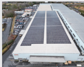
岡山工場の太陽光発電パネル
